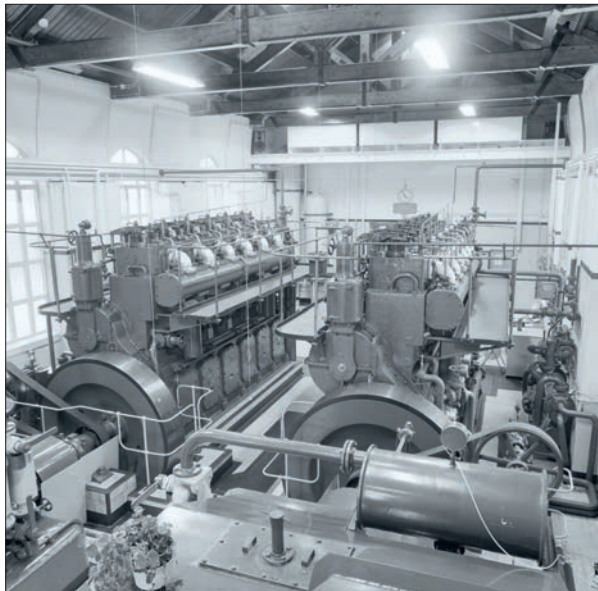
Werkspoor diesels in machinehal gemaal Spaarndam (1936).
